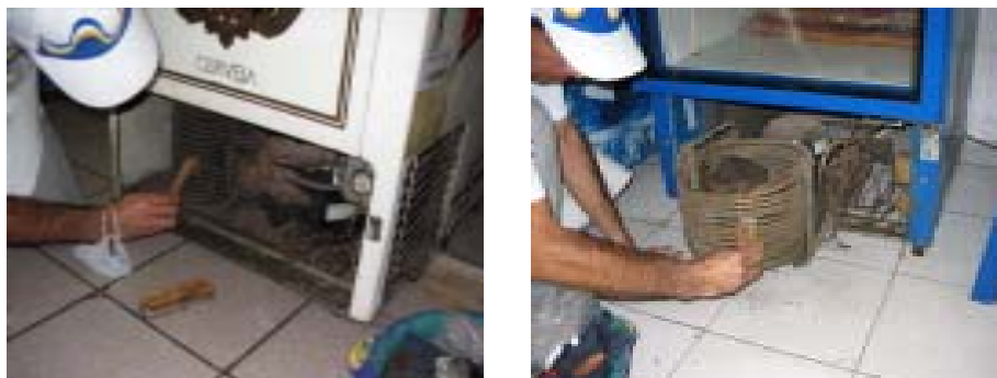
Fotos 21 e 22 - Um dos funcionários da empresa executa a limpeza do condensador de refrigerador horizontal
