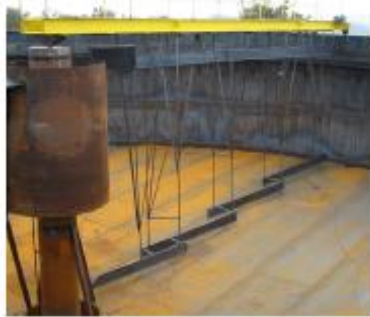
Pás removedoras de lodo (D)
