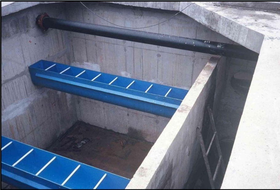
ETA Rio Grande (SABESP)
