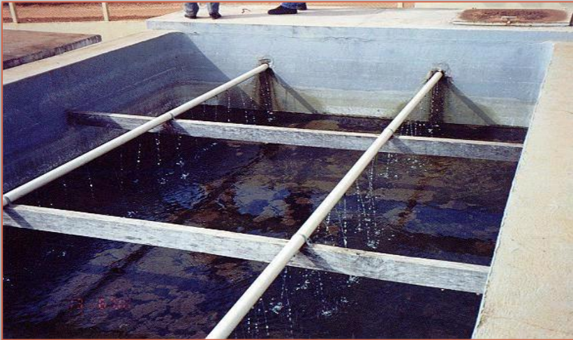
Entrada de água no filtro lento (bairro Ana Benta – Capão Bonito, SP)
