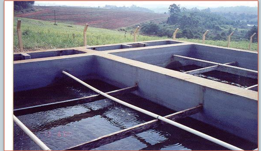
Filtro lento (bairro Ana Benta – Capão Bonito, SP) ETA construída em 1992
