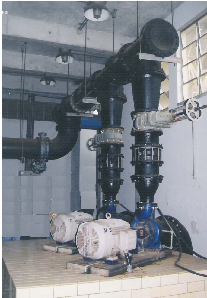
Figura 68 – Conjunto motor - bomba que recalca água para lavar os filtros
