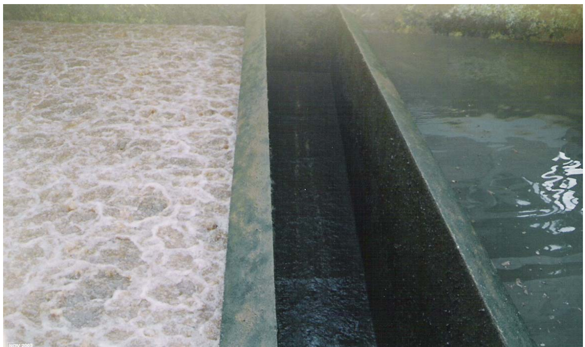
Figura 64 – Injeção de ar para limpeza das camadas do filtro
