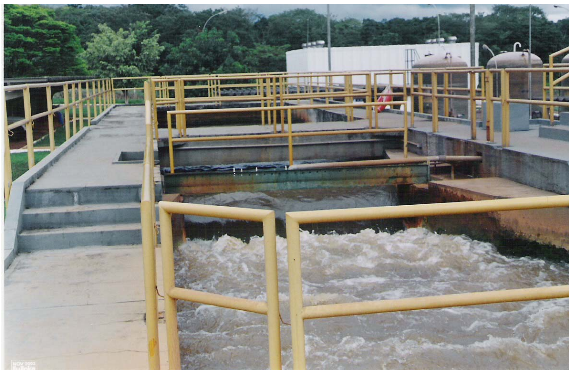
Figura 47 – Calha Parshal ( ponto de aplicação de sulfato de alumínio na ETA Meia Ponte)
