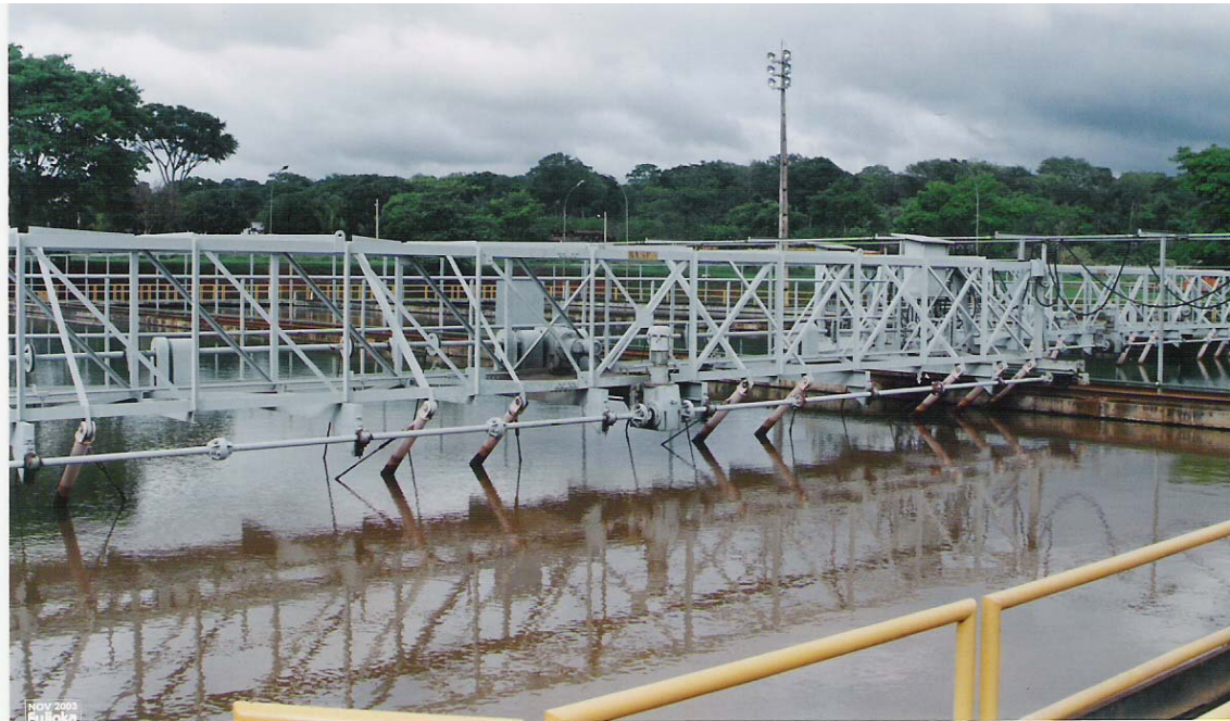
Figura 58 – Detalhe do raspador de lodo no decantador
