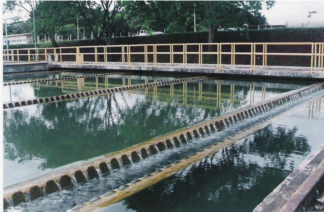
Figura 59 – Detalhe das Calhas que recebem a água decantada
