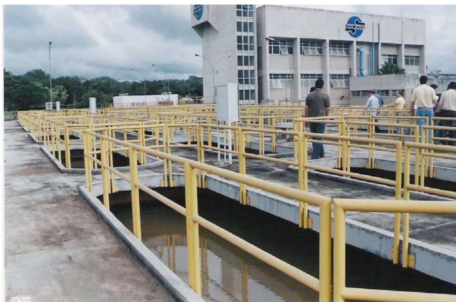
Figura 54 – Flocladores protegidos por guarda – corpos metálicos
