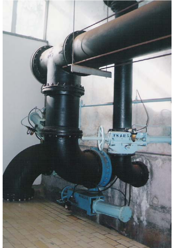
Figura 67 – Tubulação que recebe água dos filtros, localizada abaixo do nível do terreno
