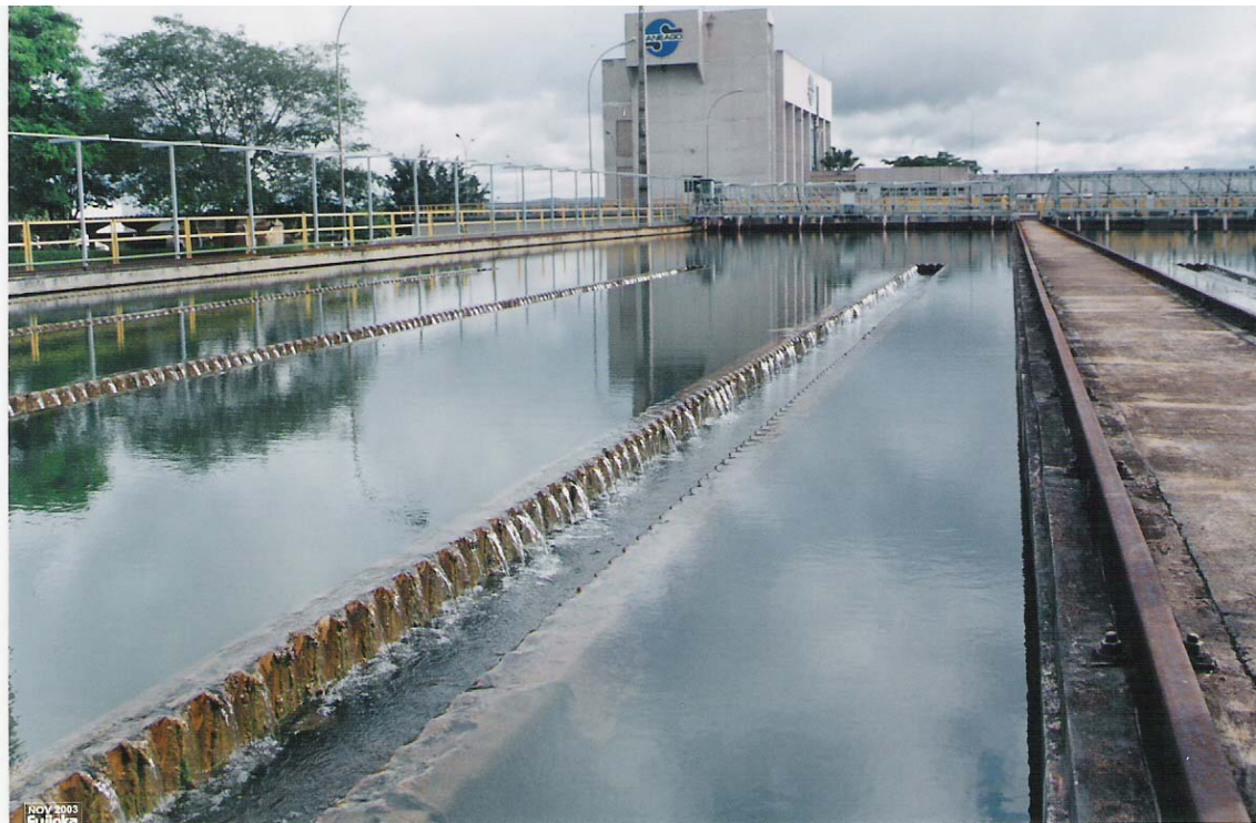
Figura 60 – Vista do decantador
